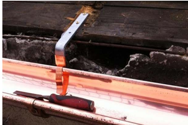
Abb. 3: Die große Ausbruchstelle nutzen Mauersegler, um in den Traufkasten zu gelangen; bautechnisch sind solch große Ausbrüche ein Problem, da Feuchtigkeit eindringen kann.
