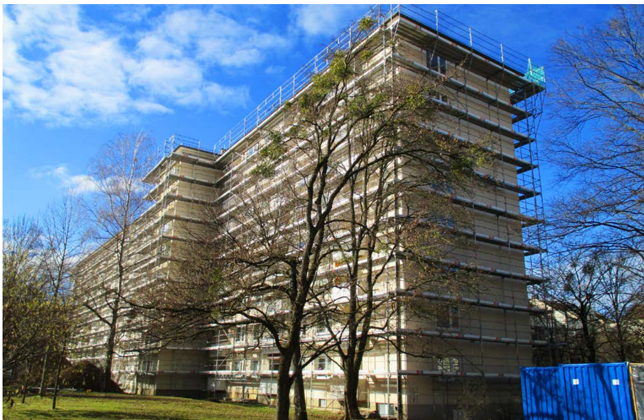
Abb. 1: Energetische Modernisierungen und andere Baumaßnahmen im Gebäudebestand können artenschutzrechtliche Verbote auslösen. Durch eine vorausschauende Planung und geeignete Vermeidungsmaßnahmen können Konflikte bereits im Vorfeld vermieden werden (alle Fotos, soweit nicht anders angegeben: Architekturbüro Hechenbichler).
