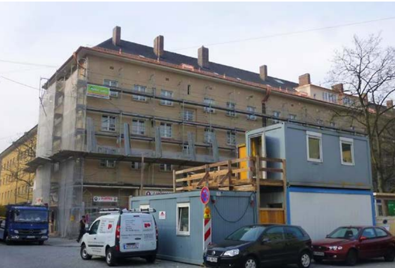
Abb. 2: Das Gerüst wurde gemäß Auflage der Höheren Naturschutzbehörde rechtzeitig vor Rückkehr der Mauersegler in Teilbereichen rückgebaut, so dass sie ihre Lebensstätten anfliegen können.
